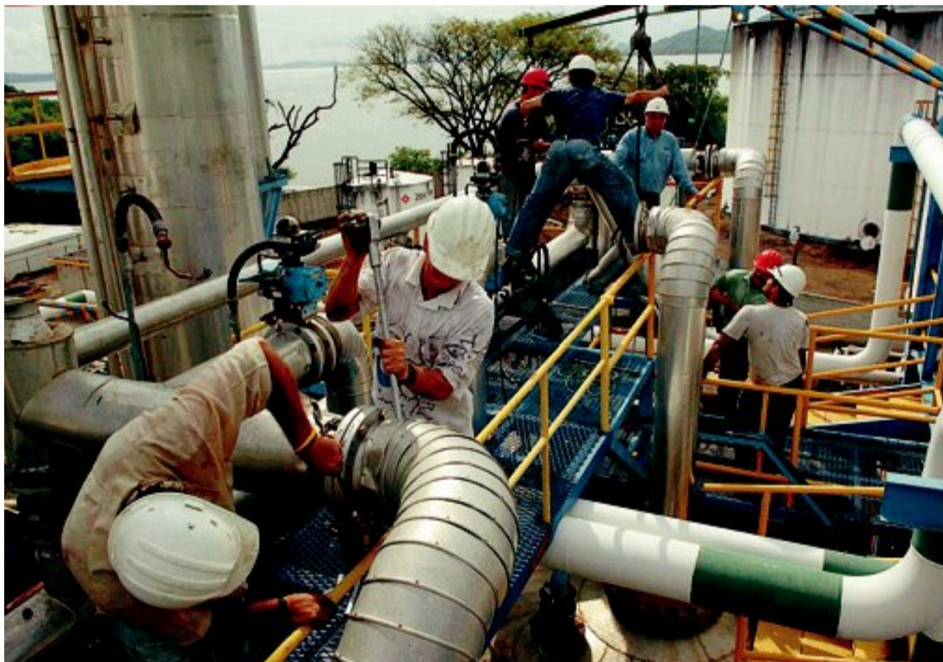
En Punta Morales, Puntarenas, opera una planta de la Liga Agrícola Industrial de la Caña que exporta etanol. Por medio de estas tuberías, el producto es transportado hasta barcos que lo llevan a Estados Unidos y Europa. Este grupo de trabajadores da mantenimiento a los conductos. MARIO ROJAS
