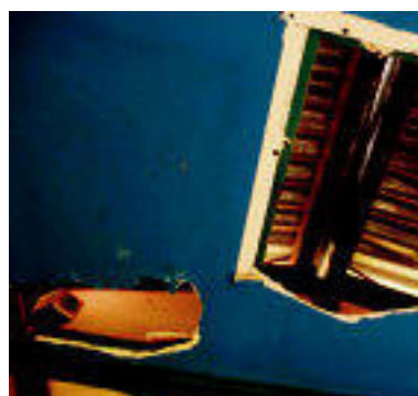
Las sustracciones y daños ocurrieron el 1.º de agosto. MARVIN CARAVACA
