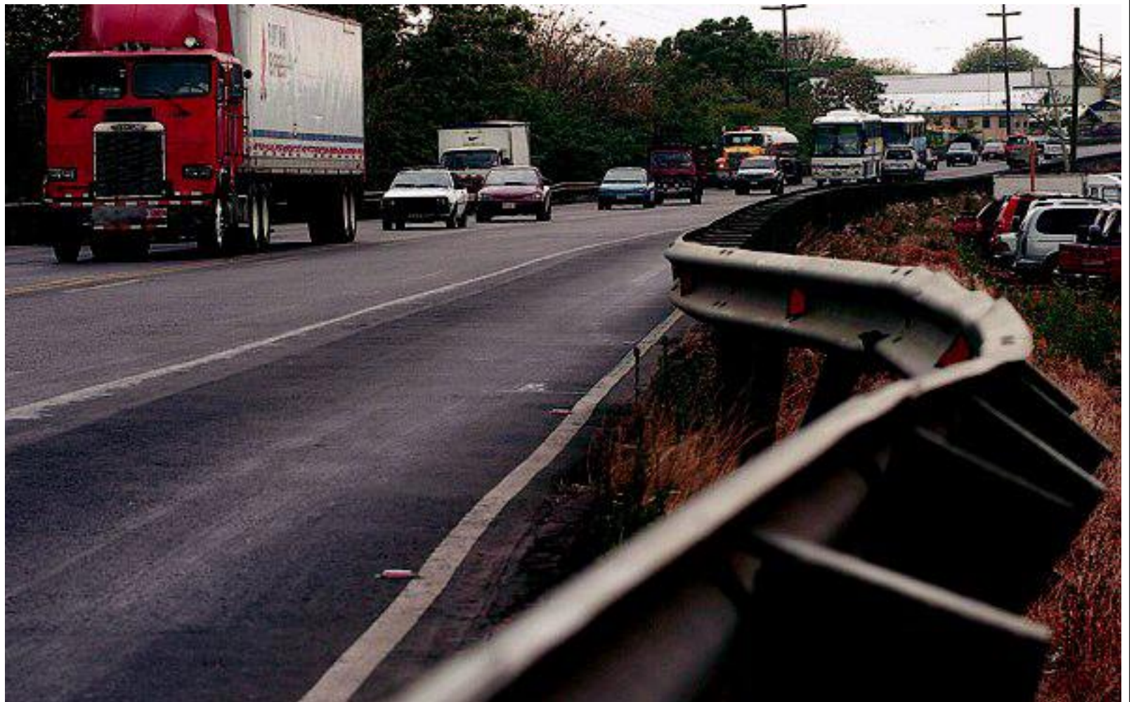
Muchos guardavías como este, ubicado sobre la carretera Bernardo Soto, en las inmediaciones del Coyol de Alajuela, se encuentran deteriorados. Según los especialistas, estas barandas no ofrecen protección a un vehículo que pierda el control y se salga de la carretera. JORGE CASTILLO
